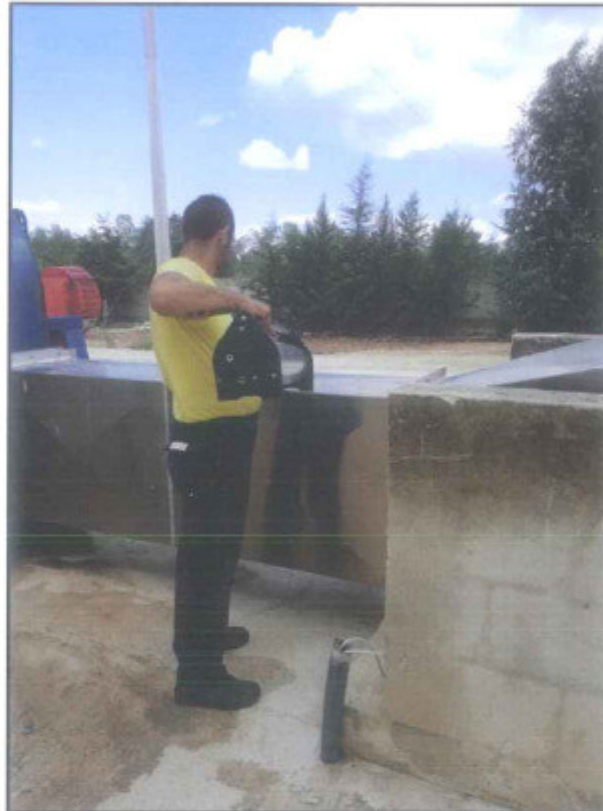
Immagine 1 – condotto di adduzione al biofiltro
